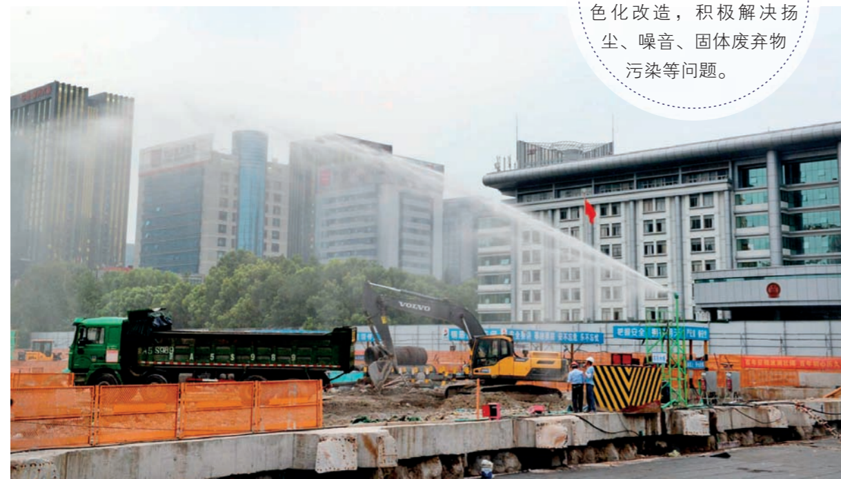
滨江区区政府南广场地下停车场工程获评杭州市唯一一家“无废工地”。
